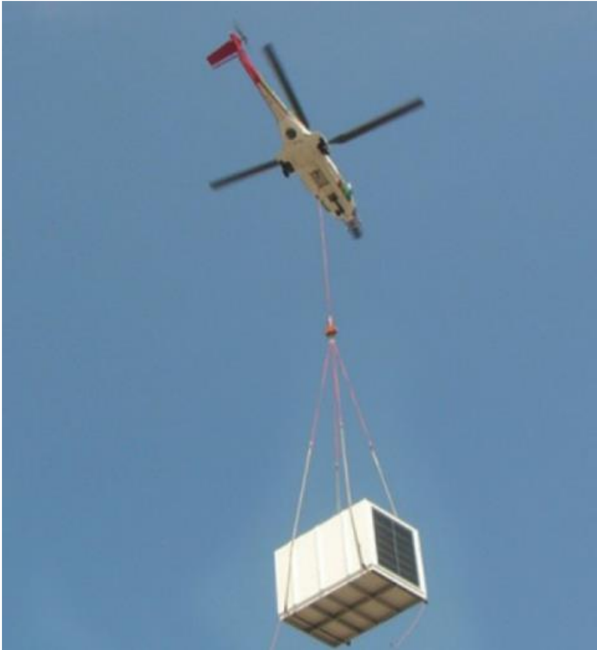
L'héliportage, une solution retenue pour installer les pièces de gaine sur une toiture.
